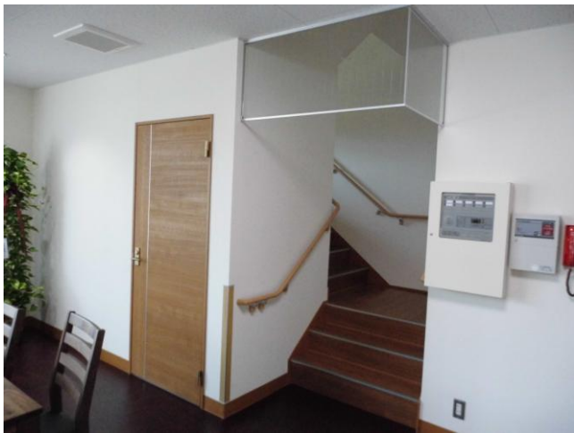
1 階から 2 階への階段と火災報知機・通報装置
